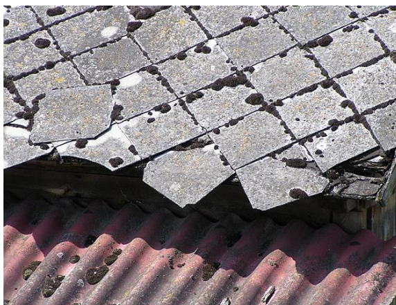
Rys. 8. Pokrycie dachowe ocenione w I stopniu pilności.
