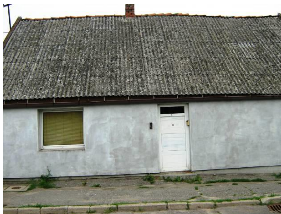
Rys. 7. Pokrycie dachowe ocenione w II stopniu pilności.
