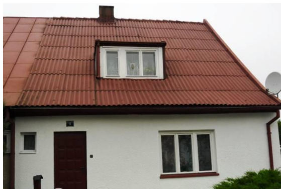
Rys. 6. Pokrycie dachowe ocenione w III stopniu pilności.
